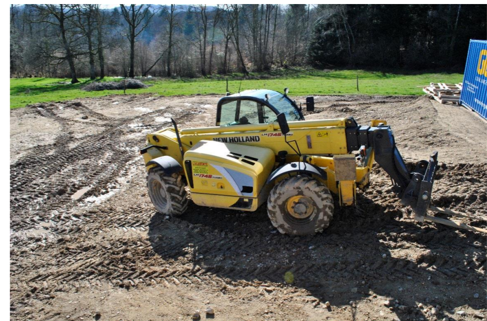
Photographie 51 : Exemple de tassement et d'ornières créés par les engins de chantier
